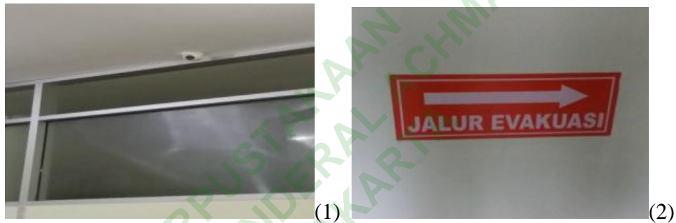
Gambar 4. 16 (1) CCTV dan (2) petunjuk jalur evakuasi
