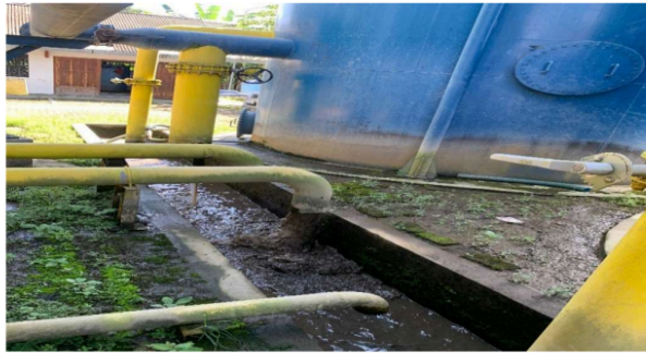
Gambar 4.3 Pipa Pembuangan Sedimentasi
